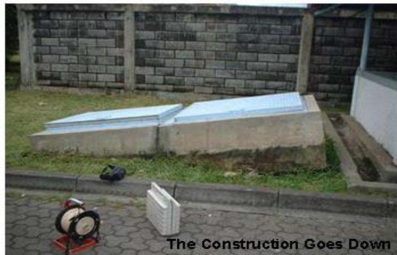
バンドンでの地盤沈下被害 (Geological Environment 2003)
